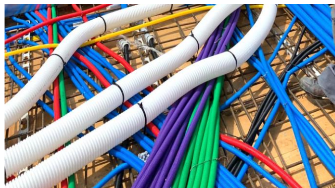
Bild: Rohre und Kabel am Laufmeter
